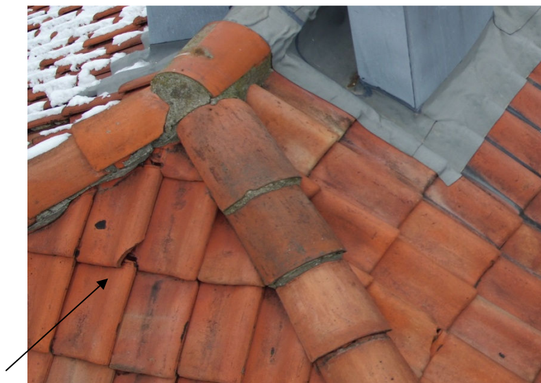
En kilde til fremtidig svampeskade, der ikke kan ses fra gadeplan
